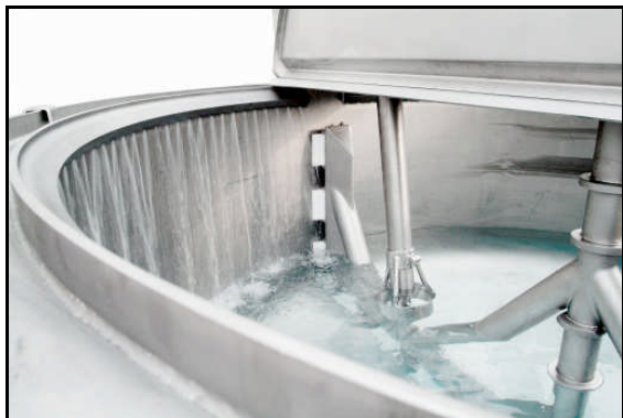
Abbildung 2: Reinhaltung der Behälterwand mittels Abstreifern und Düsen
